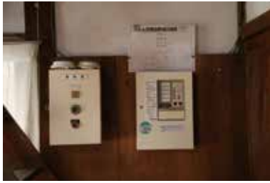
【管理施設】 自動火災報知設備
