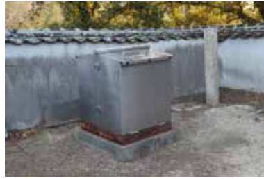
【管理施設】 屋外消火栓設備（放水銃）
