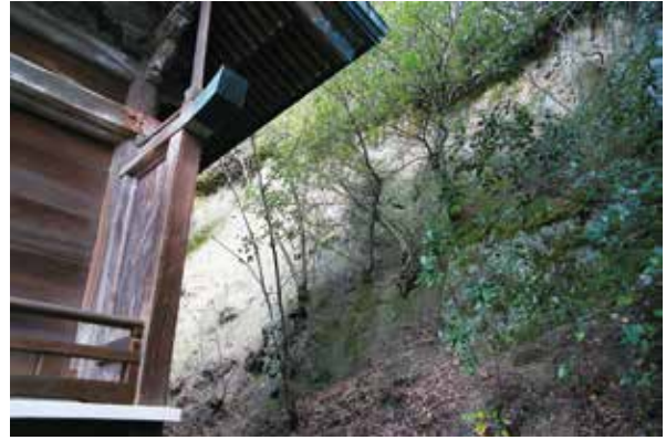
高浜八幡神社 社殿北側の法面の崩落
