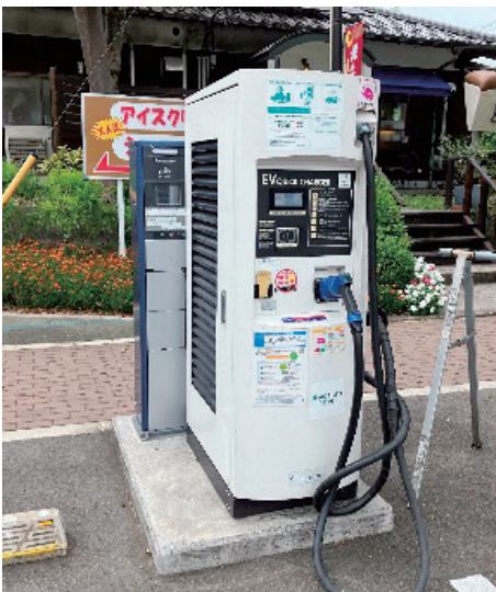
道の駅にある急速EV充電器（参考）
