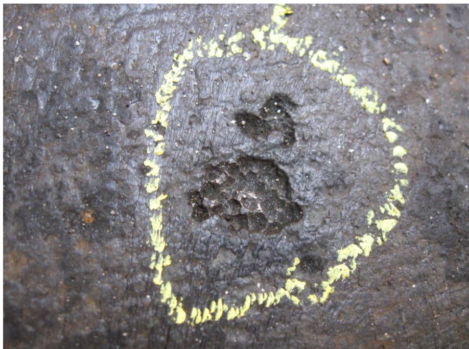
図 3-6 劣化診断調査で発見した管路の腐食
