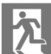
避難口誘導灯
