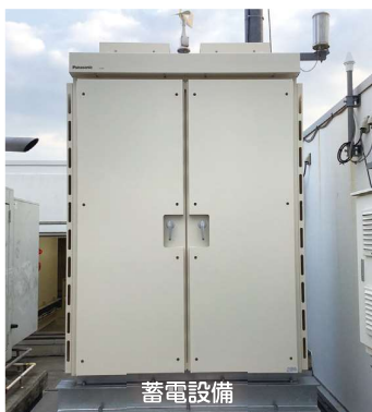
太陽光発電設備（岩城総合支所屋上）
