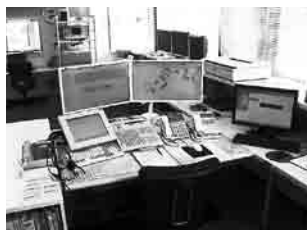
通信指令台設置状況
