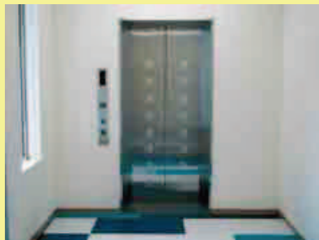
整備されたエレベーター
